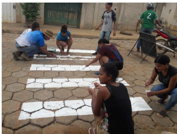
Figura 14 - Sinalização em Angelândia, 2019.
